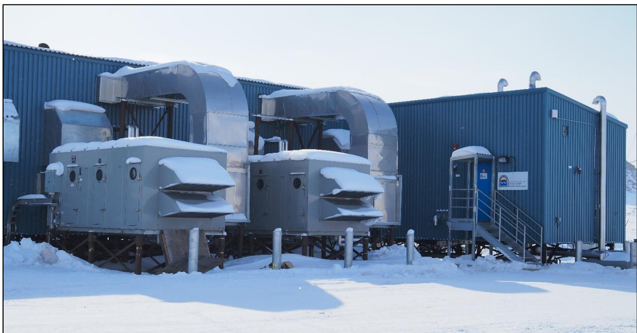
Centrale électrique de Qikiqtarjuaq, construite en 2016
