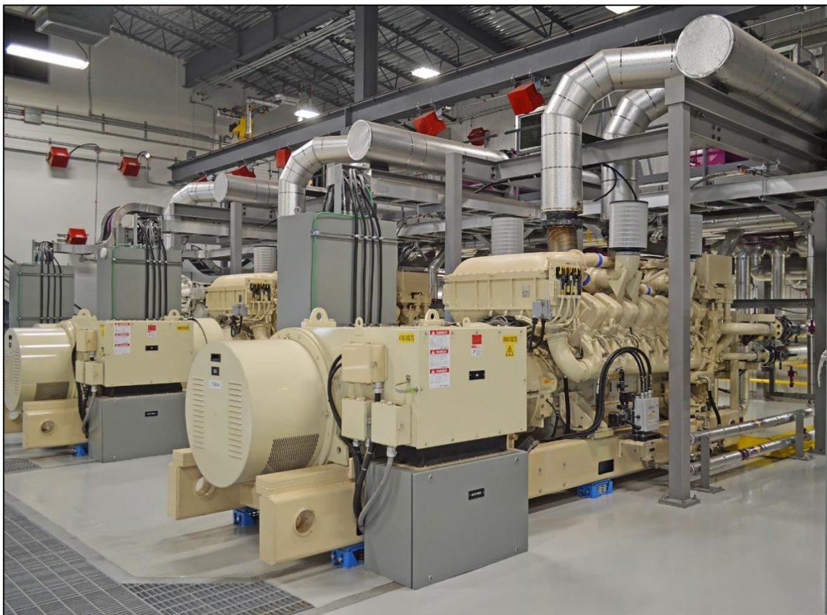
Centrale électrique de Kinngait, construite en 2018
